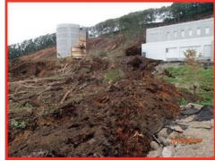
浄水場の地盤の崩壊
